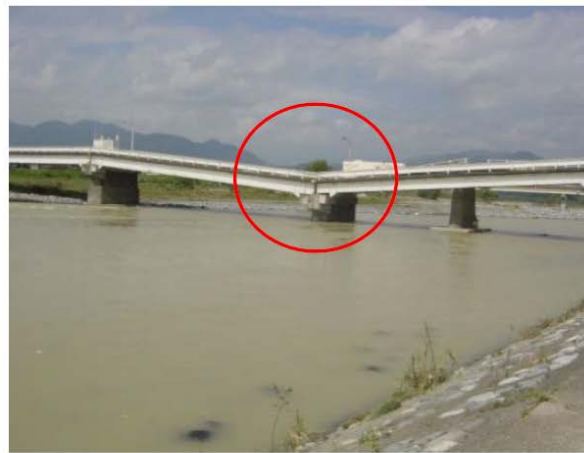
橋脚の洗掘・沈下 国土交通省「下部構造の損傷事例」より
