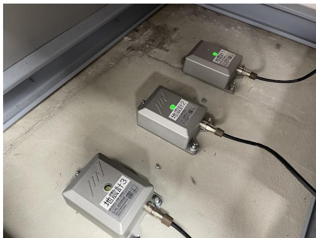
A社設置状況
